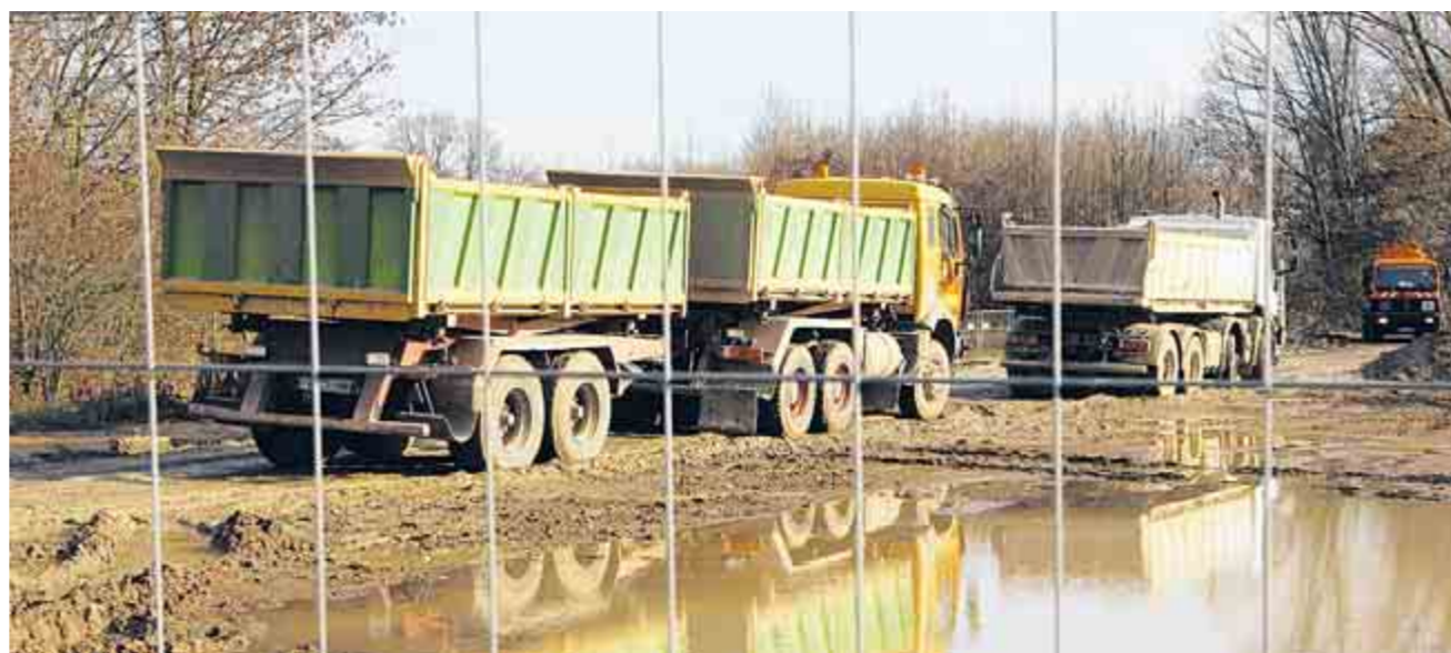
Die Baulaster stehen schon Schlange, um den Aushub für den Durchstich des Niddaaltarms abzutransportieren.
