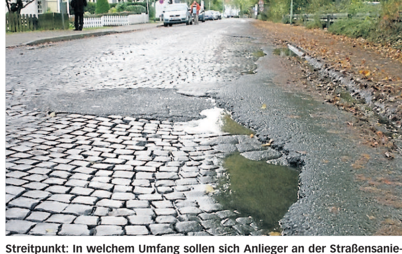
Streitpunkt: In welchem Umfang sollen sich Anlieger an der Straßensanierung, wie etwa in der Dieselstraße beteiligen? Foto: Dieter Deul
